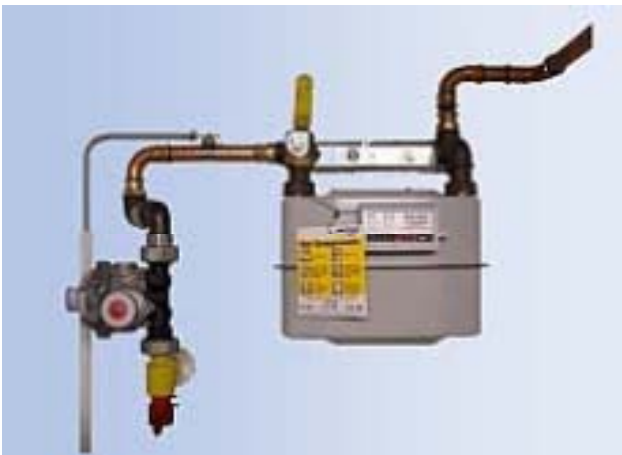
Bild 4: Zählerplatz im Gebäude
