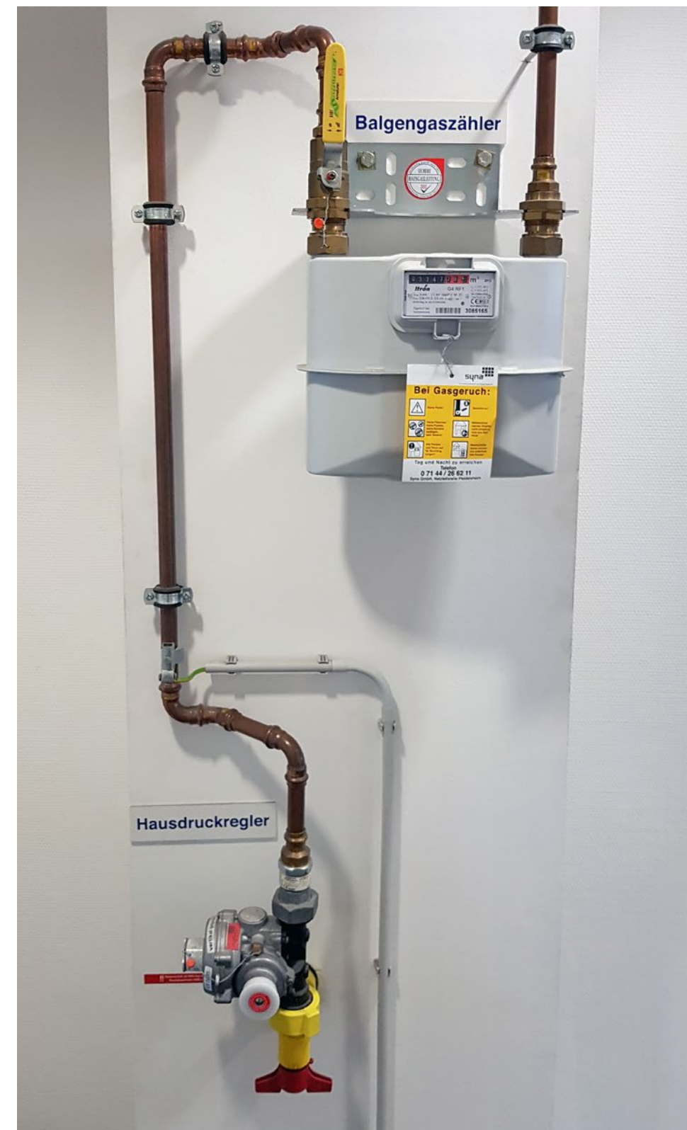
Gas-Netzanschluss und Gas-Zählerplatz
